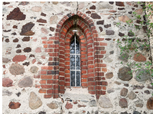
Risse und Abbrüche gefährden den Bestand der Dorfkirche
